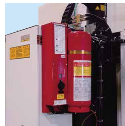
自動消火装置 (注)
