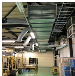
コンプレッサの排熱対策2
