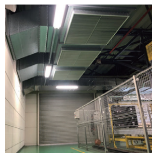
コンプレッサの排熱対策3
