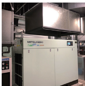
コンプレッサの排熱対策1
