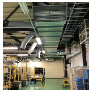
コンプレッサの排熱対策2
