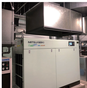
コンプレッサの排熱対策1
