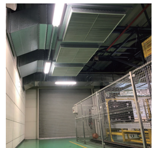
コンプレッサの排熱対策3
